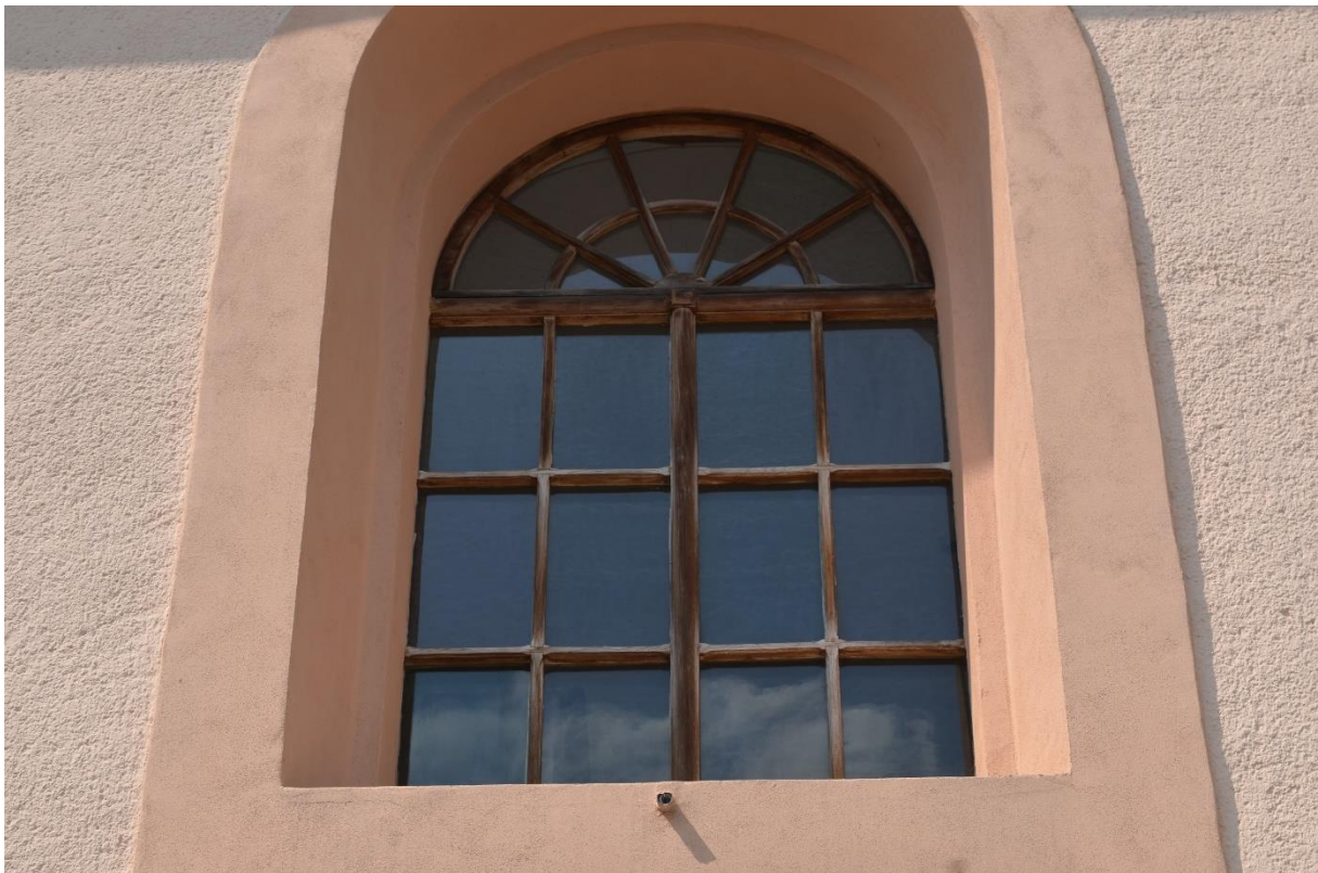
Fot. 4 Okno drugiej kondygnacji elewacji południowej o konstrukcji krosnowej ze szczelinami krzyżowymi z nadświetleniem ze szczelinami w układzie promienistym: od strony zewnętrznej prawie w całości pozbawione warstw ochronnych/ malarskich.
